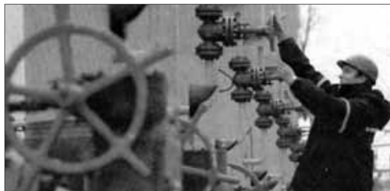
Russische Erdgas-Pipeline nach Westeuropa: Eine kurze Drehung – und nichts fliesst mehr.
